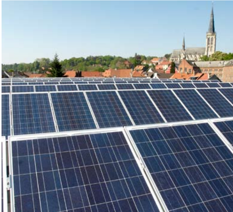
De panelen op het dak van de Colruyt-winkel in Alsemberg zorgen ervoor dat de winkel op zonnige dagen bijna volledig op zonne-energie kan draaien.
