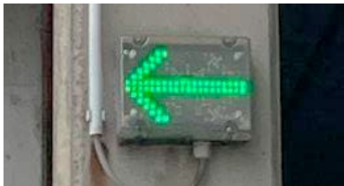
Figuur 1 – Groene pijl staat aan. Het voertuig mag geplaatst of verplaatst worden.
