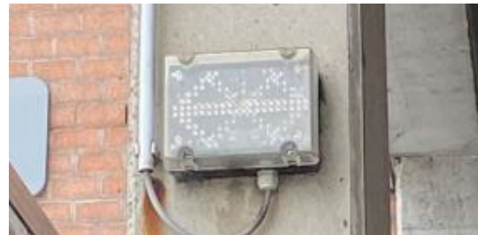
Figuur 2 – Groene pijl staat uit. Het voertuig mag niet geplaatst of verplaatst worden.
